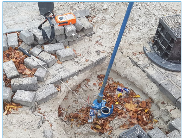
Detectie van het gas bij het andere einde
